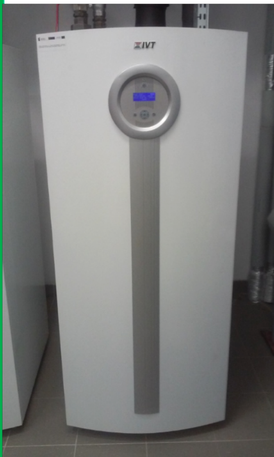
Pompa ciepła – 10 kW ele.
